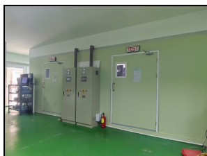
写真⑥：恒温槽
