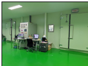
写真③： 恒温恒湿槽（10万BTU）
