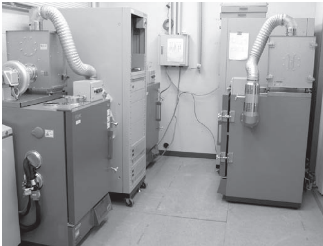
充放電評価試験設備
